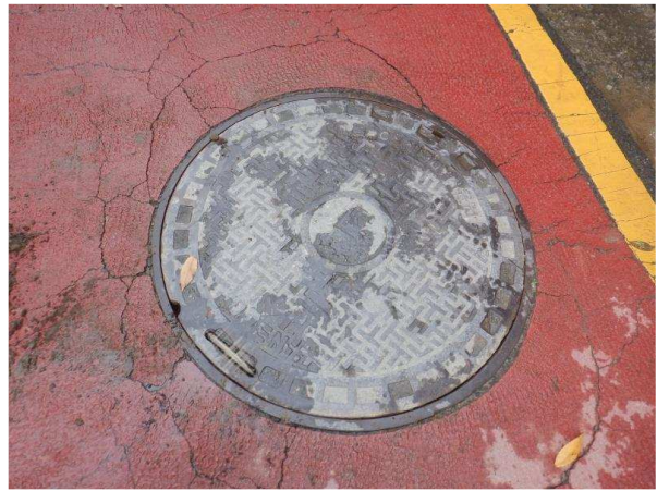
내용 맨홀 뚜껑 상태양호
