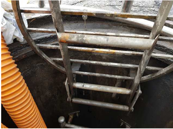
내용 안전손잡이 안전손잡이 파손
