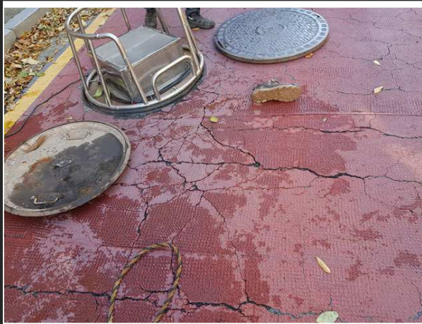
내용 포장부 아스콘 망상균열
