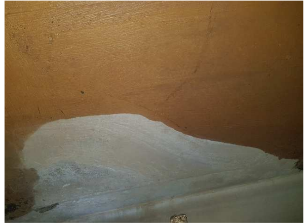
내용 상부슬래브 균열
