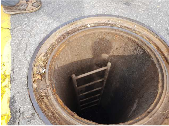
내용 안전손잡이 안전손잡이 탈락
