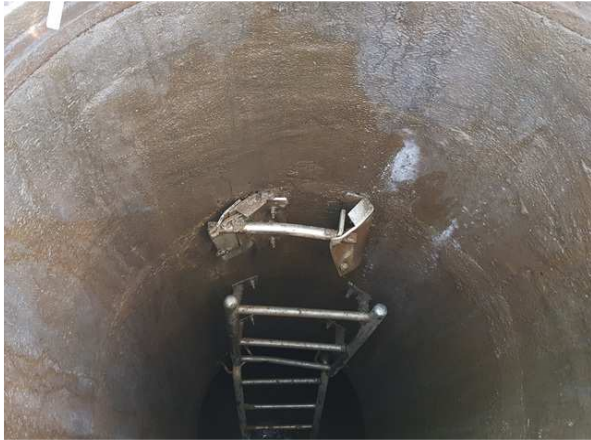
내용 안전사다리 안전사다리 파손
